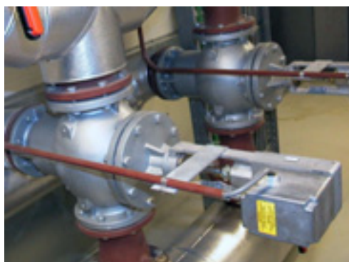
Figuur 478 Elektrische regelklep in proces
