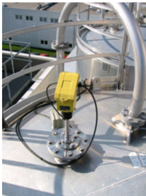
Figuur 299 Ultrasonische meting in gesloten tank
