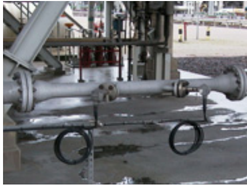
Figuur 369 Aansluiting ultrasone flowtransmitters
