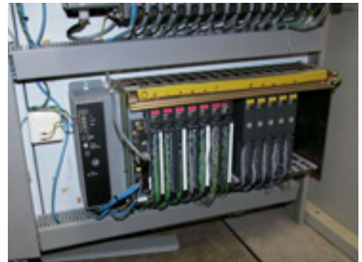
Figuur 575 centrale processor unit
