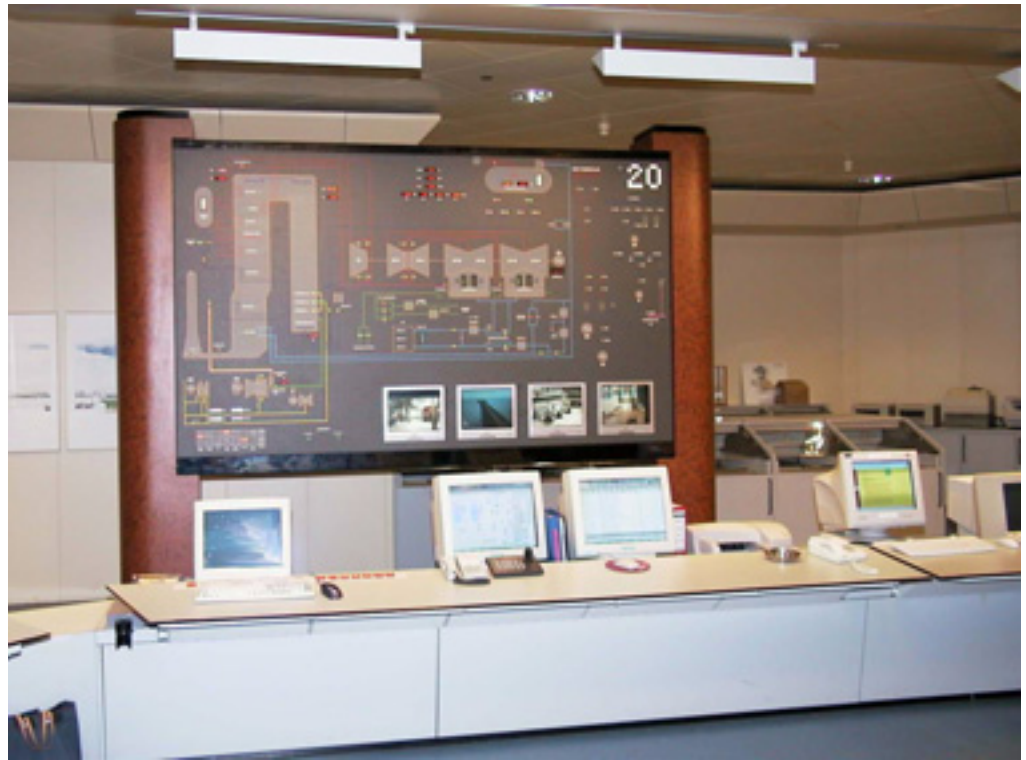
Figuur 565 Deel van controlekamer
