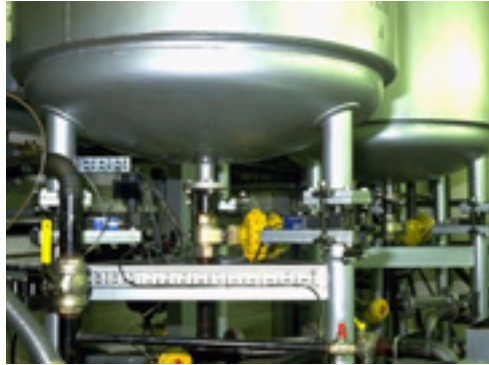
Figuur 459 Weegtank (bron: B.V. VEGA meet- en regeltechniek)
