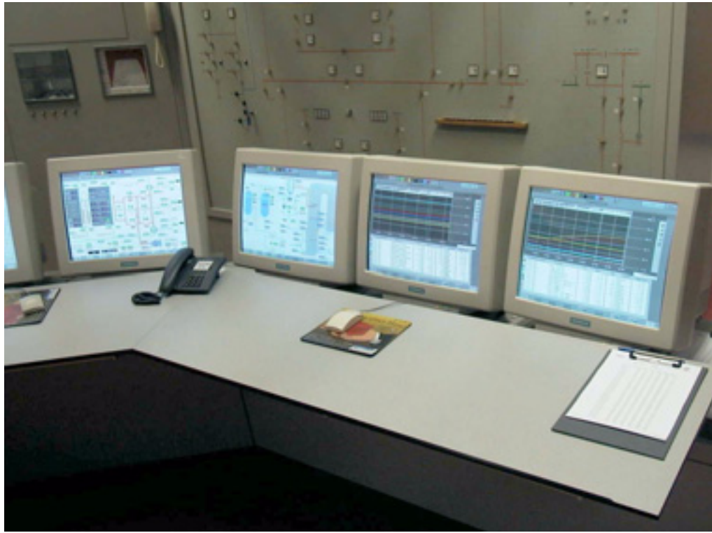
Figuur 569 Moderne controlekamer met bedieningsstations
