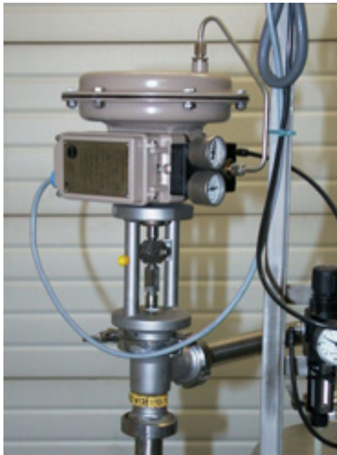
Figuur 9 Pneumatisch bediende regelklep
