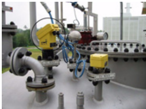
Figuur 261 Niveautransmitter met radarsensor (bron: B.V. VEGA meet- en regeltechniek)
